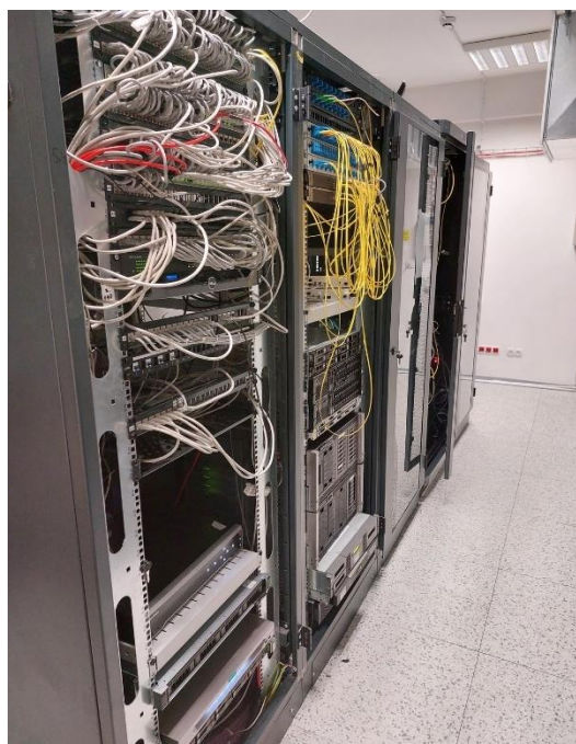
Zdjęcie nr 1: Widok ogólny na szafy serwerowe
